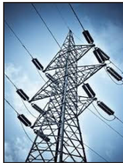
cabos / linhas de alta tensão
