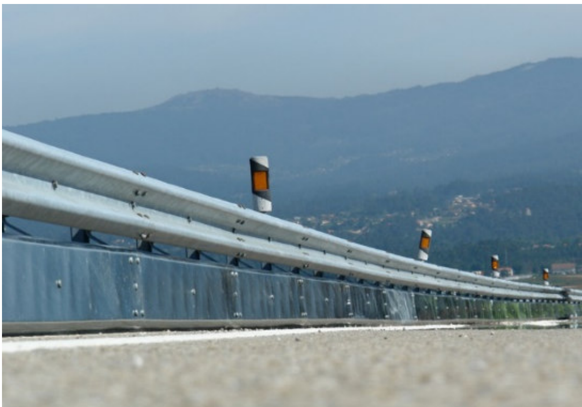
Figura 2 - Curva com rail de dupla saia metálica previne o risco de morte ou feridos graves.
