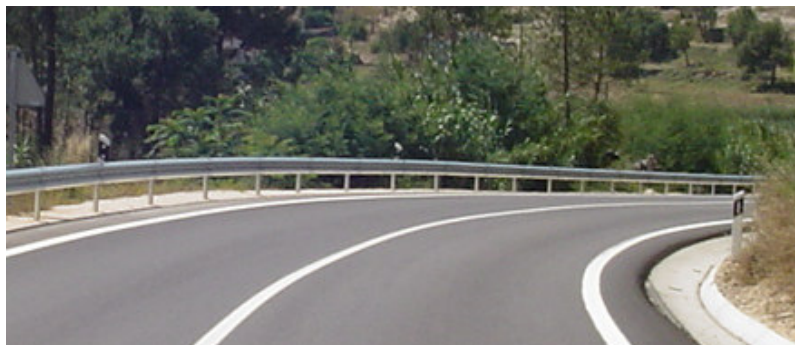
Figura 9: Curva com Rail sem dupla saia metálica coloca em risco a vida dos motociclistas.
