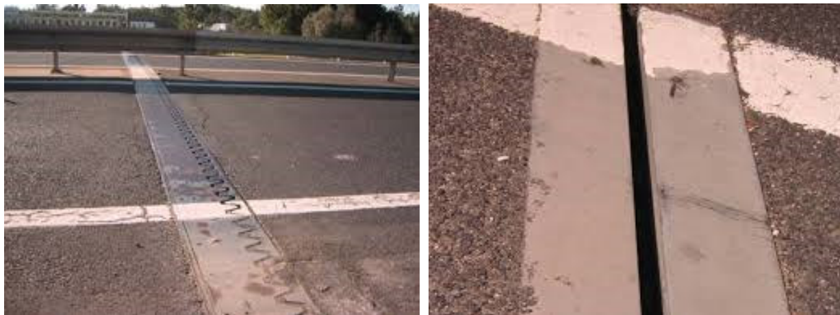
Figura 7: Juntas de dilatação “escorregadias” em especial para os veículos de 2 rodas a motor.
