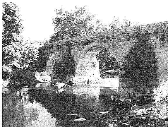
(b) Quebra - mares entre os arcos 1 e 2 e arcos 2 e 3 - Vista de montante - lado de Famalicão
