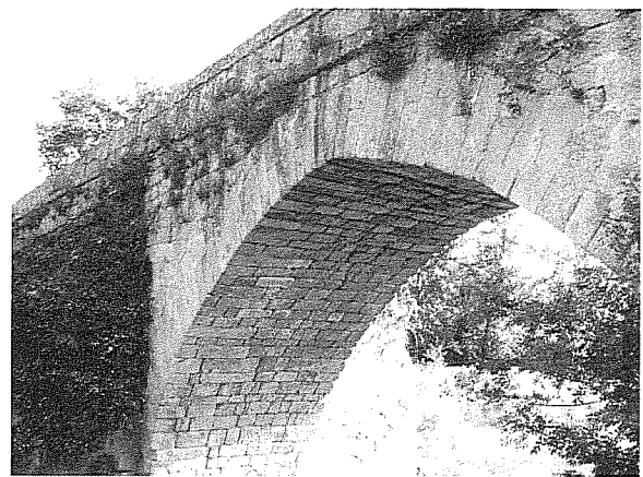
(b) Falta de argamassa – Arco 2
