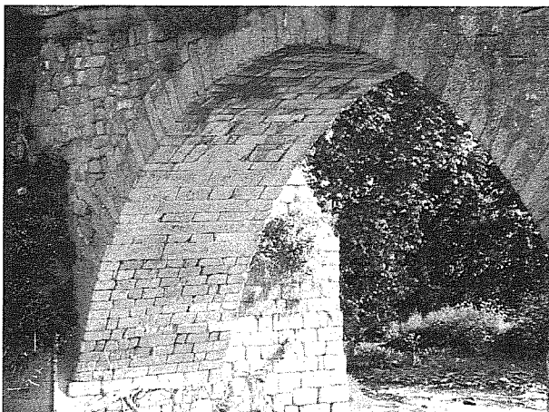
(a) Falta de argamassa – Arco 2
