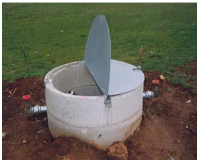
Hidrante, contador volumétrico e saídas de rega
