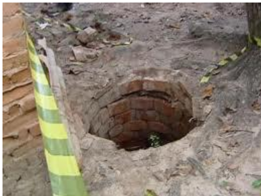
Figura 20 – Poço sem cobertura ou resguardo eficaz
