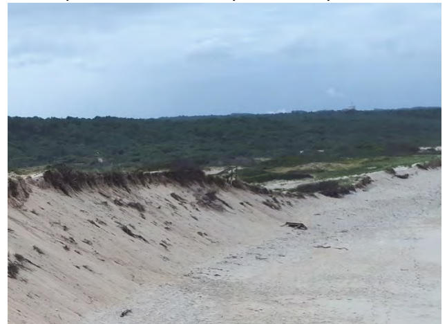
10.20 Extremidade destruída do passadiço no local em que existe uma acentuada redução da cota da arriba de erosão na duna.
