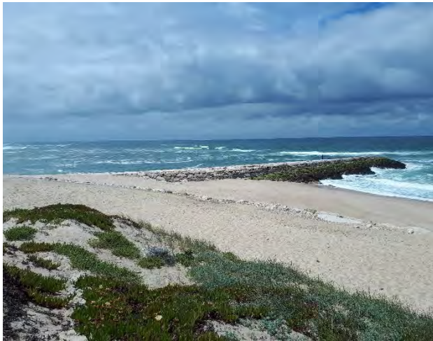
10.5. Estrutura de defesa aderente, em enrocamento, entre os esporões nº 5 e nº 4.
