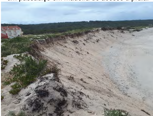
10.9 Vista para sul da zona a intervir mais próxima do enraizamento do esporão nº 5, evidenciando o acentuado talude de erosão.
