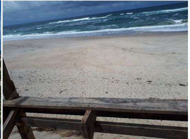
10.18 Extremidade do passadiço a sul do esporão destruída pela ação do mar. Não é possível o acesso pedonal à praia.
