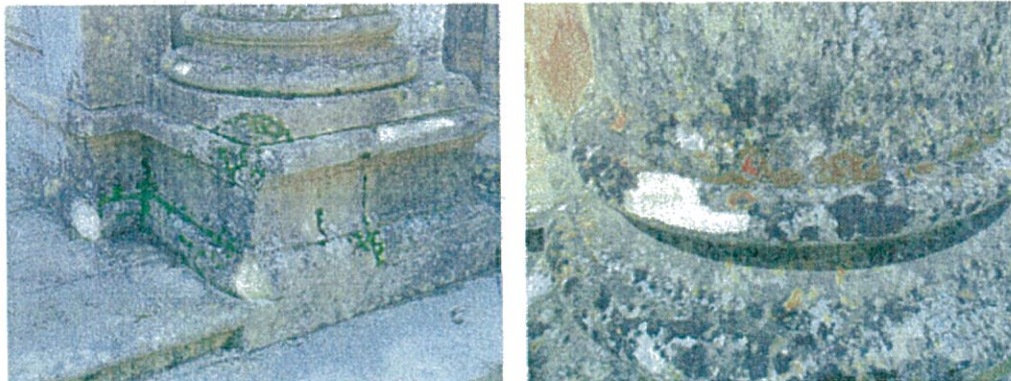
Imagem 5 – Lacunas com perda de material no piso térreo que serão colmatados com argamassas de estucagem no Claustro D. João III
