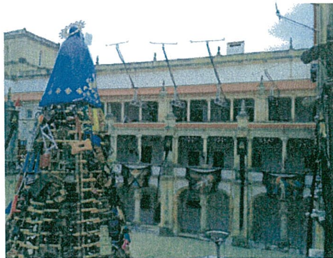
Imagem 2 – sistema de spinklers na cobertura do Claustro da Hospedaria ligado a depósito de 17.000 litros de água
