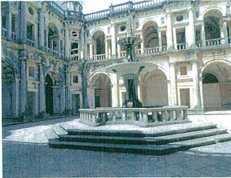
Imagem 3 – Claustro de D João III onde se verificam os danos na pedra
