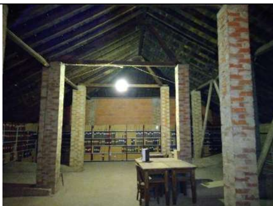
Fotografia da visita realizada – vista do interior da cobertura do edifício principal
