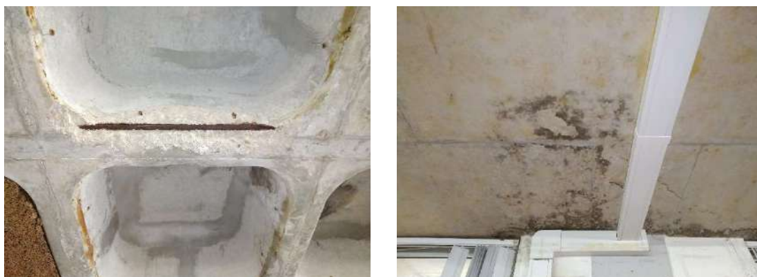
Zonas com degradação visível nas lajes provocadas por corrosão nas armaduras: armaduras expostas nas nervuras (esq.); destacamento na zona maciça junto a um pilar (dir.)
