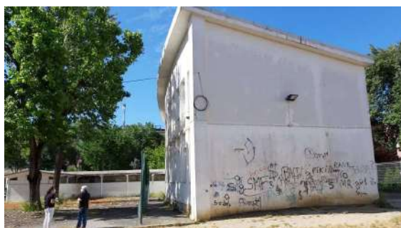
Termofurese reveladora da presença de um sistema reticulado de betão armado e alvenarias de enchimento
