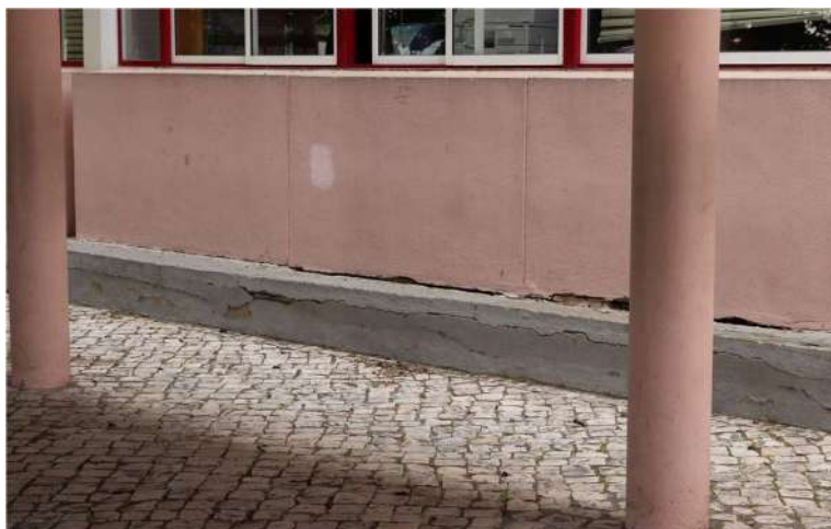
Problemas de assentamentos junto às vigas de fundação
