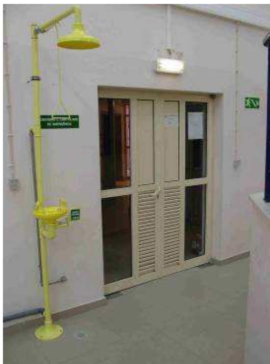
Figura 3 – Exemplo de conjunto chuveiro e lava-olhos instalado junto da saída de um laboratório
