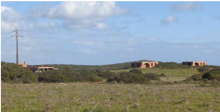
Figura 20 - Fundações e estruturas abandonadas
