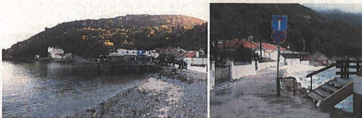
Figura 14 – Caminho de acesso ao restaurante o farol. Na preia-mar o mar atinge a base da estrutura de protecção e, durante os temporais, é comum a água galgar a infra-estrutura, pondo em causa a integridade da mesma e das construções aí existentes. De notar que o restaurante Galeão (na imagem da esquerda), que nos anos cinquenta se encontrava construído sobre areia de praia, se encontra hoje sobre estacas devido ao recuo da linha de costa verificado no Portinho.
