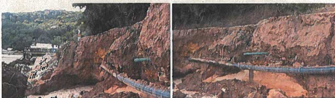
Figura 16 – Erosão do aterro construído para dar acesso à zona do Creiro, tendo ficado exposta a canalização da água (7) .
